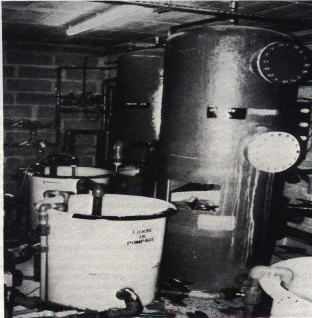
Salle des machines des circuits fermés de l'INRA de Rennes. Cette salle contient les principaux équipements de la chaîne de traitement de trois circuits fermés de 12 \text{ m}^3/\text{h} chacun, dont un en eau de mer, à savoir : fecal-traps, fosses de pompage (cuves blanches) et pompes, filtres bactériens sous pression à haut rendement (cylindres gris), et unités de stérilisation ultraviolet. La vitesse de passage opérationnelle dans ces filtres bactériens est de 27 \text{ m/h} (conception de l'auteur).
